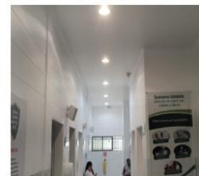
Luminarias pasillos- después
