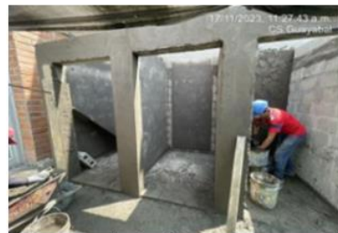
Cuarto de residuos – antes
